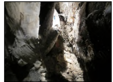
Photo N° 109 AMIANTE CIMENT Sous Sol Conduits Fourreau
