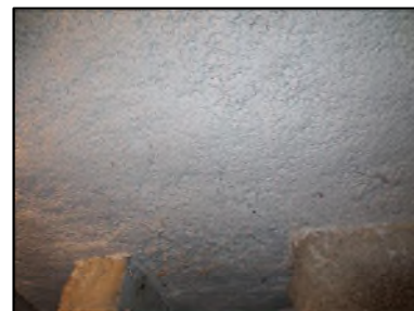
Photo N° 105 ECH-N°1 FLOCAGE Sous Sol Plafonds Cotonneux blanc
