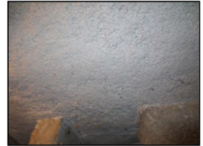
Photo N° 105 ECH-N°1 FLOCAGE Sous Sol Plafonds Cotonneux blanc
