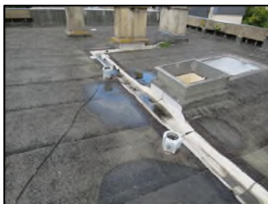
Photo N° 98 AMIANTE CIMENT Toiture Terrasse Conduits de ventilation Ventilation haute (Fibres- ciment)
