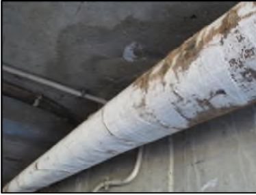
Photo N° 659 CALORIFUGEAGE -- COULOIR DE CAVE Conduits de fluide Laine minérale + enveloppe plâtrée
