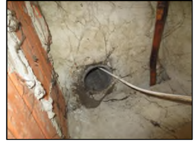
Photo N° 675 AMIANTE CIMENT -- Gaine technique 4 Conduits Ventilation haute (Fibres-ciment)
