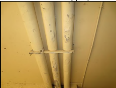
Photo N° 677 ECH-N°2 CALORIFUGEAGE --PORCHE Conduits de fluide Laine minérale + enveloppe plâtrée
