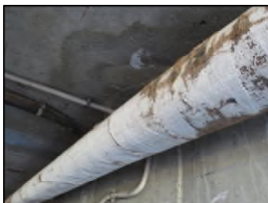
Photo N° 659 ECH-N°3 CALORIFUGEAGE --COULOIR DE CAVE Conduits de fluide Laine minérale + enveloppe plâtrée
