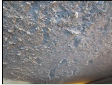
Photo N° 663 ECH-N°1 FLOCAGE -- COULOIR DE CAVE Plafonds Blanc cotonneux
