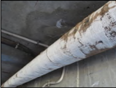
Photo N° 659 ECH-N°3 CALORIFUGEAGE --COULOIR DE CAVE Conduits de fluide Laine minérale + enveloppe plâtrée
