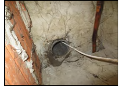
Photo N° 675 AMIANTE CIMENT -- Gaine technique 2 Conduits Ventilation haute (Fibres-ciment)
