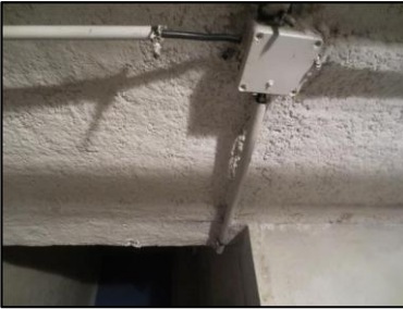
Photo N° 1110 ECH-N°1 FLOCAGE - -DEGAGEMENT -1 Plafonds flocage
