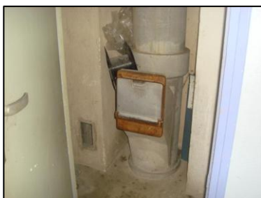
Photo N° 5945 AMIANTE CIMENT -- LOCAL VO -1 à +4 Conduits de fluide Gaine V.O.(Fibres-ciment)
