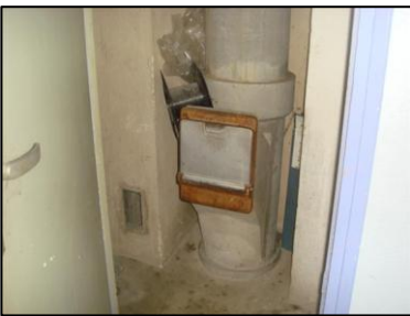
Photo N° 5945 AMIANTE CIMENT - -LOCAL VO -1 à +4 Conduits de fluide Gaine V.O.(Fibres-ciment)
