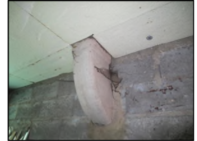
Photo N° 625 AMIANTE CIMENT -- Local objets encombrants Conduits de fluide Ventilation haute (Fibres- ciment)
