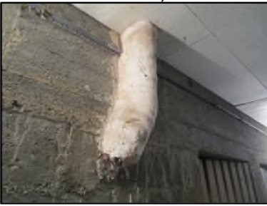
Photo N° 626 ECH-N°1 CALORIFUGEAGE --Local objets encombrants Conduits de fluide Laine minérale + enveloppe plâtrée
