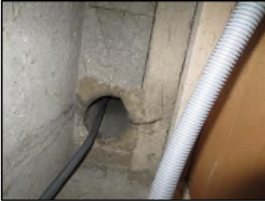
Photo N° 621 AMIANTE CIMENT -- Gaine technique gaz 2 Conduits de fluide Ventilation haute (Fibres- ciment)
