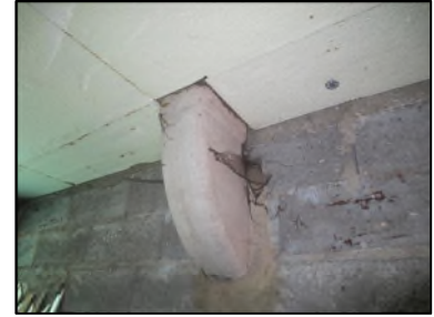
Photo N° 625 AMIANTE CIMENT -- Local objets encombrants Conduits de fluide Ventilation haute (Fibres- ciment)
