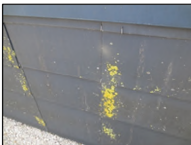
Photo N° 143 ECH-N°4 AMIANTE CIMENT Toiture Terrasse Murs Plaques planes (Fibres-ciment)
