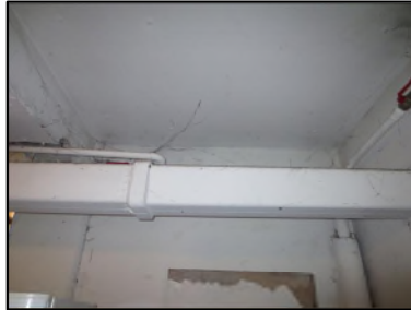
Photo N° 149 AMIANTE CIMENT Local Vélo RDC Gains & coffres horizontaux Ventilation haute (Fibres-ciment)
