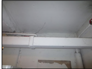
Photo N° 149 AMIANTE CIMENT Local Vélo RDC Gainses & coffres horizontaux Ventilation haute (Fibres-ciment)
