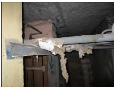
Photo N° 151 ECH-N°1 FLOCAGE Sous Sol Plafonds Flocage
