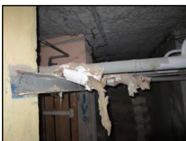
Photo N° 151 ECH-N°1 FLOCAGE Sous Sol Plafonds Flocage
