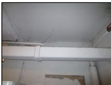
Photo N° 149 AMIANTE CIMENT Local Vélo RDC Gainses & coffres horizontaux Ventilation haute (Fibres- ciment)
