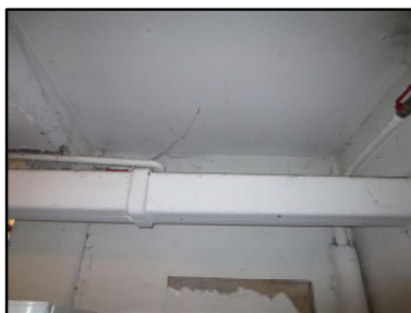
Photo N° 149 AMIANTE CIMENT Local Vélo RDC Gainses & coffres horizontaux Ventilation haute (Fibres-ciment)
