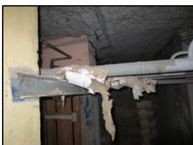
Photo N° 151 ECH-N°1 FLOCAGE Sous Sol Plafonds Flocage
