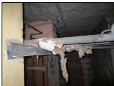
Photo N° 151 ECH-N°1 FLOCAGE Sous Sol Plafonds Flocage
