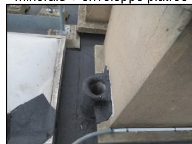
Photo N° 505 AMIANTE CIMENT Terrasse Plafonds Ventilation haute (Fibres-ciment)
