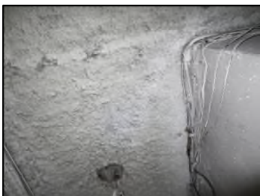
Photo N° 501 ECH-N°1 FLOCAGE COULOIR DE CAVE Plafonds Cotonneux
