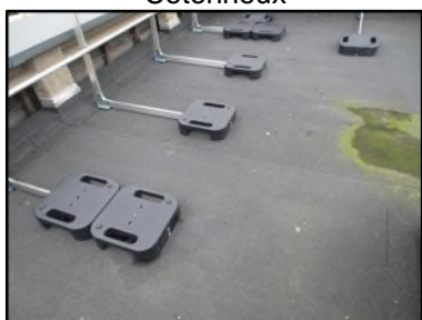
Photo N° 506 ECH-N°5 --FACADE Planchers Revêtement goudronné
