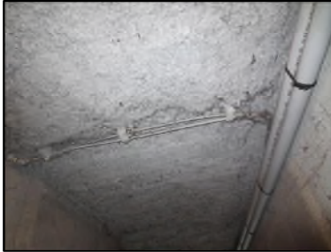
Photo N° 495 ECH-N°1 FLOCAGE - S.sol-LOCAL CHAUFFERIE Plafonds Flocage cotonneux
