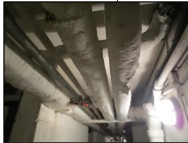
Photo N° 518 ECH-N°3 CALORIFUGEAGE -S.sol-COULOIR DE CAVE Conduits de fluide Laine minérale + enveloppe plâtrée
