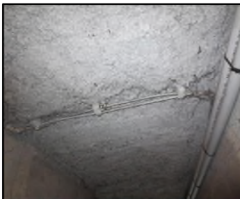
Photo N° 495 ECH-N°1 FLOCAGE -S.sol- LOCAL CHAUFFER Plafonds Flocage cotonneux
