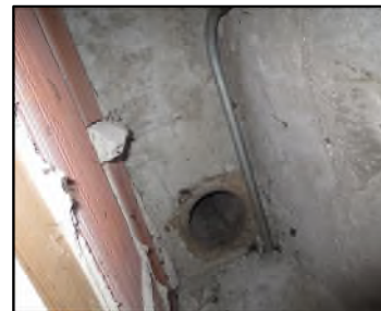
Photo N° 511 AMIANTE CIMENT -Gaine technique Gaz 15 & Gaines & coffres verticaux Ventilatio haute (Fibres-cimen
