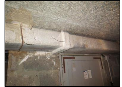
Photo N° 1208 AMIANTE CIMENT -- COULOIRS DE CAVES -1 Conduit Ventilation haute (Fibres-ciment)
