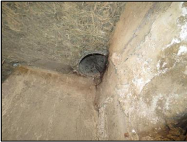
Photo N° 1206 AMIANTE CIMENT -- COULOIRS DE CAVES RDC Conduit Fourreau
