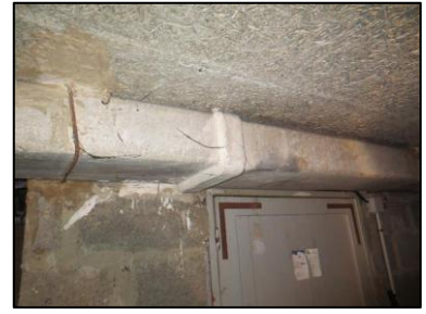
Photo N° 1208 AMIANTE CIMENT - -COULOIRS DE CAVES -1 Conduit Ventilation haute (Fibres-ciment)
