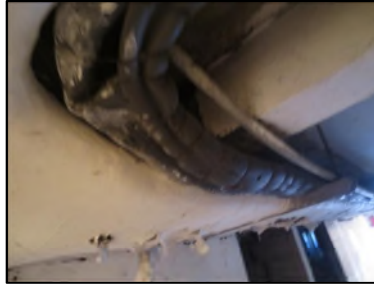
Photo N° 545 ECH-N°2 CALORIFUGEAGE COULOIR DE CAVE_S.sol Conduits de fluide Laine minérale + enveloppe plâtrée
