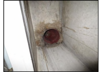
Photo N° 549 AMIANTE CIMENT -- NC-Gaine Technique 13 Conduits de ventilation Ventilation haute (Fibres- ciment)
