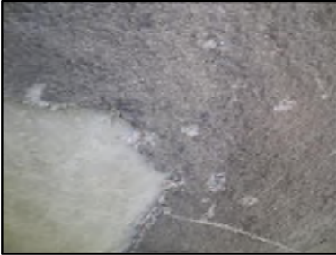
Photo N° 528 ECH-N°1 FLOCAGE - COULOIR DE CAVE_S.sol Plafonds Flocage
