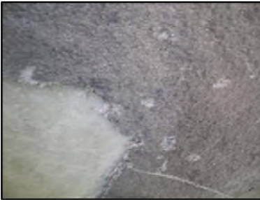
Photo N° 528 ECH-N°1 FLOCAGE - COULOIR DE CAVE_S.sol Plafonds Flocage
