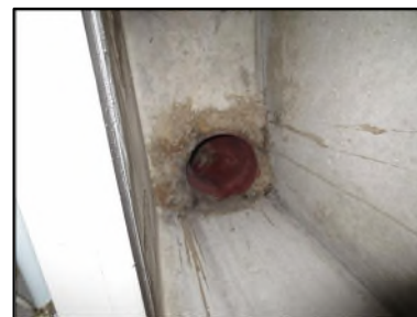
Photo N° 549 AMIANTE CIMENT -- NC-Gaine Technique 13 Conduits de ventilation Ventilation haute (Fibres- ciment)
