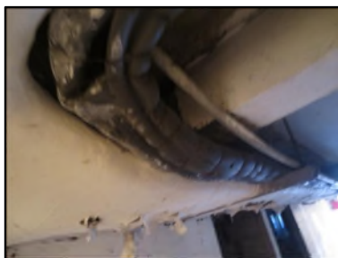
Photo N° 545 ECH-N°2 CALORIFUGEAGE - COULOIR DE CAVE_S.sol Conduits de fluide Laine minérale + enveloppe plâtrée
