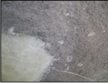
Photo N° 528 ECH-N°1 FLOCAGE COULOIR DE CAVE_S.sol Plafonds Flocage
