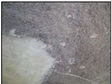
Photo N° 528 ECH-N°1 FLOCAGE - COULOIR DE CAVE_S.sol Plafonds Flocage
