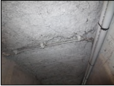
Photo N° 495 ECH-N°1 FLOCAGE - COULOIR DE CAVE_S.sol
