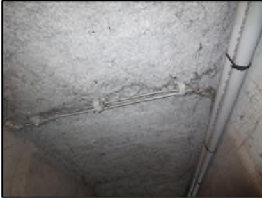
Photo N° 495 ECH-N°1 FLOCAGE - COULOIR DE CAVE_S.sol
