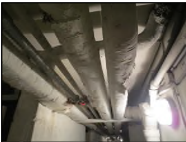
Photo N° 518 ECH-N°2 CALORIFUGEAGE COULOIR DE CAVE_S.sol Conduits de fluide Laine minérale + enveloppe plâtrée
