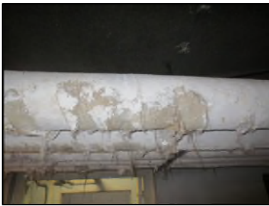
Photo N° 529 ECH-N°2 CALORIFUGEAGE COULOIR CAVE_S.sol Conduits de fluide Laine minérale + enveloppe plâtrée
