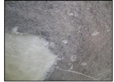
Photo N° 528 ECH-N°1 FLOCAGE -- LOCAL CHAUFFERIE_S.sol Plafonds flocage cotonneux blanc
