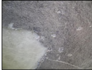
Photo N° 528 ECH-N°3 FLOCAGE SOUS SOL Plafonds FLOCAGE
