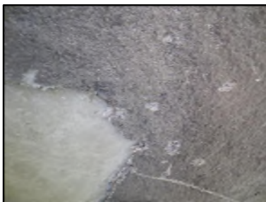
Photo N° 528 ECH-N°3 FLOCAGE SOUS SOL Plafonds FLOCAGE
