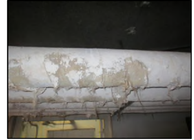
Photo N° 529 ECH-N°2 CALORIFUGEAGE Sous sol Conduits de fluide Laine minérale + enveloppe plâtrée
