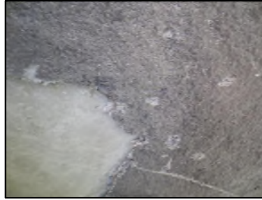
Photo N° 528 ECH-N°3 FLOCAGE SOUS SOL Plafonds FLOCAGE
