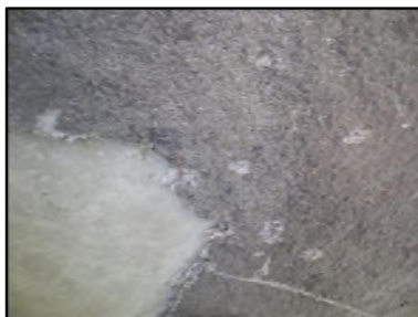
Photo N° 528 ECH-N°3 FLOCAGE SOUS SOL Plafonds FLOCAGE
