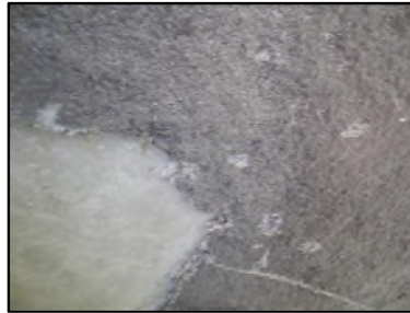
Photo N° 528 ECH-N°3 FLOCAGE SOUS SOL Plafonds FLOCAGE
