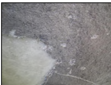
Photo N° 528 ECH-N°3 FLOCAGE SOUS SOL Plafonds FLOCAGE
