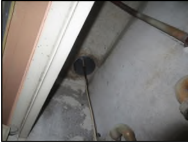
Photo N° 526 AMIANTE CIMENT Local vide ordure 12 Gainses & coffres verticaux Gaine V.O.(Fibres- ciment)
