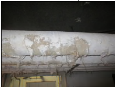
Photo o N° 529 ECH-N°2 CALORIFUGEAGE COULOIR CAVE_S.sol Conduits de fluide Laine minérale + enveloppe plâtrée
