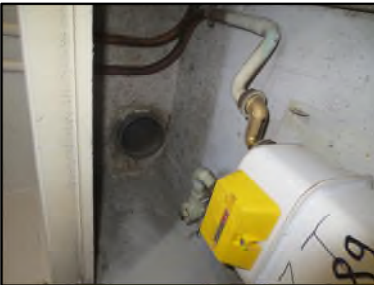
Photo N° 541 AMIANTE CIMENT -- Gaine technique 4 Gainés & coffres horizontaux Ventilation haute (Fibres-ciment)
