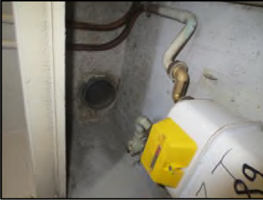
Photo N° 541 AMIANTE CIMENT -- Gaine technique 4 Gainés & coffres horizontaux Ventilation haute (Fibres-ciment)
