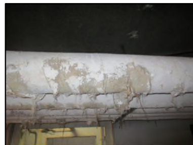
Photo N° 529 ECH-N°2 CALORIFUGEAGE Sous sol Conduits de fluide Laine minérale + enveloppe plâtrée
